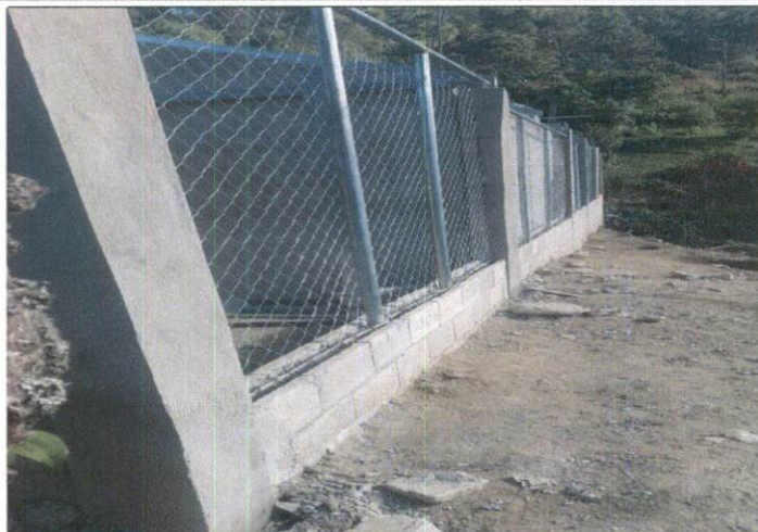
Foto 2: En el lado sur del establecimiento quedó de esta manera el muro o cerco perimetral.
